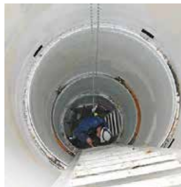
Exemple de puits d'accès en ZNS © Close et al., 2012.
